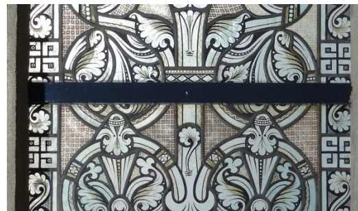
Abb. 181: Sturmeisen nach den Deckanstrichen
