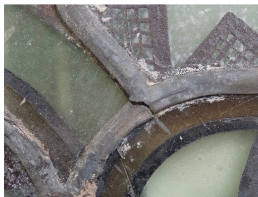
Abb. 136: Bleibruch neben einem erneuerten Glas (rechts unten)
