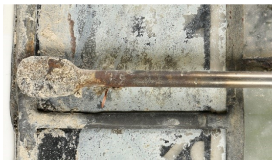
Abb. 140: korrodierte Lasche des Windeisens
