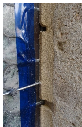
Abb. 185: Lücken im Mörtel durch Holzleisten
