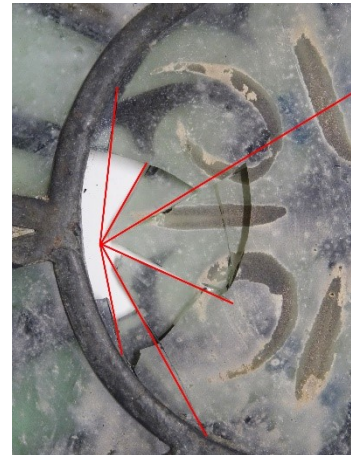
Abb. 119: Brüche im Glas ausgehend von einem Punkt, Bleifeld 1d
