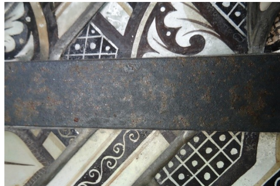
Abb. 143: Korrosion am Sturmeisen
