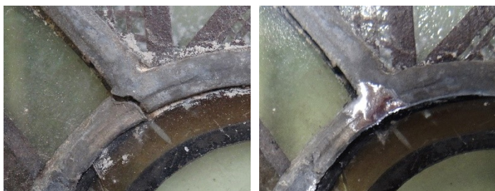
Abb. 173: Bleibruch vor der Lötung (links) und nach der Lötung (rechts)
