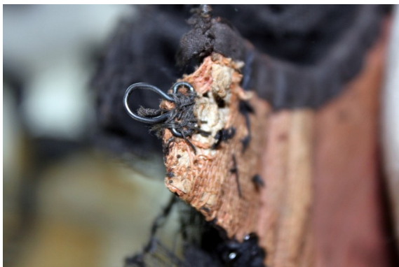
Abb. 247: Schadhafes Futter, Verschluss links, Haube A
