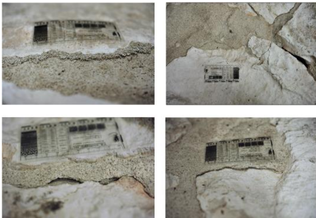
Abb. 67-70: Desolate Kittungen; Auswaschung des Bindemittels, Abwitterung der Oberfläche, Flankenrisse.
