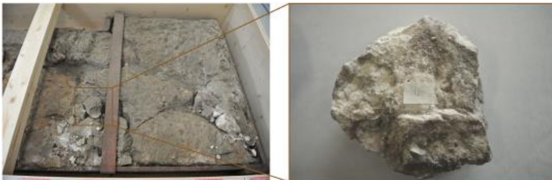
Abb. 62: Beispiel eines lose aufliegenden Steinfragmentes.
