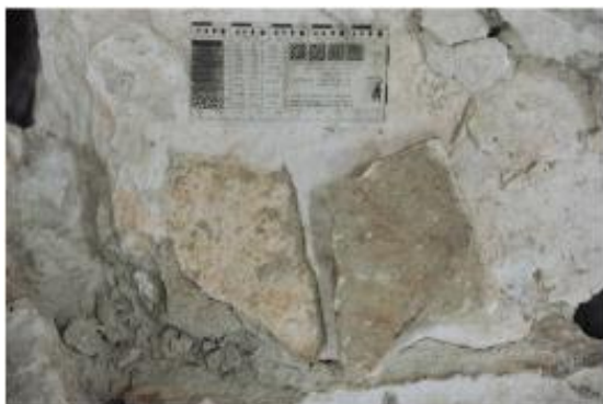
Abb. 46: geöffnete, alte Klebung mit speckiger Oberfläche
