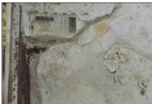
Abb. 61: rostendes Eisen mit Abplatzungen.
