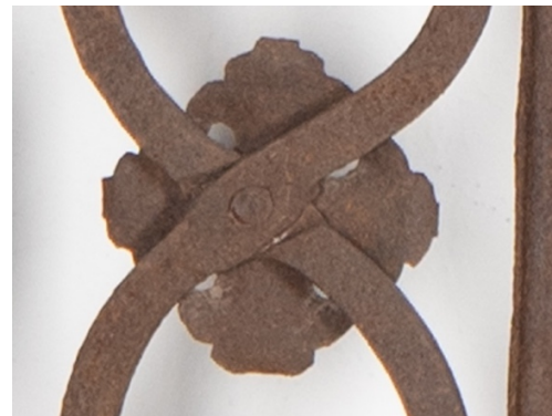
Abb. 117, Stehflügel, unterer Fries, fehlende Zierrosette.
