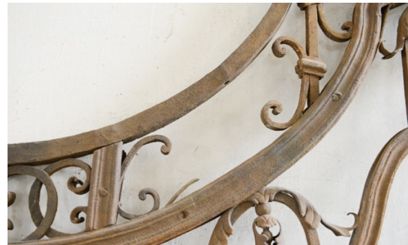
Abb. 115, Gehflügel, oberer Bogenfries, fehlende C-Bögen.
