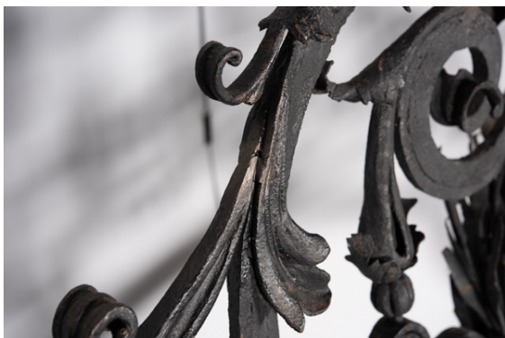
Abb. 136, Toraufsatz, zentraler Bereich, Fehlende Blattranken auf der rechten Seite.
