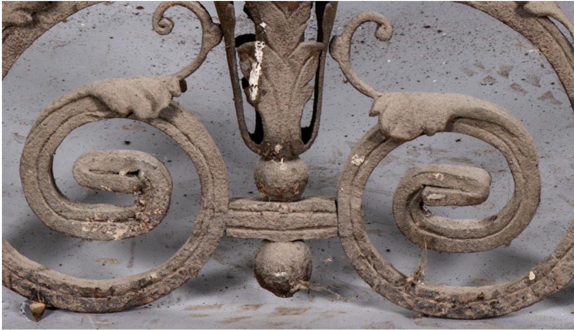
Abb. 103, Füllelement, massive Staub- und Schmutzauflagen, darunter befindliche Muldenkorrosion.
