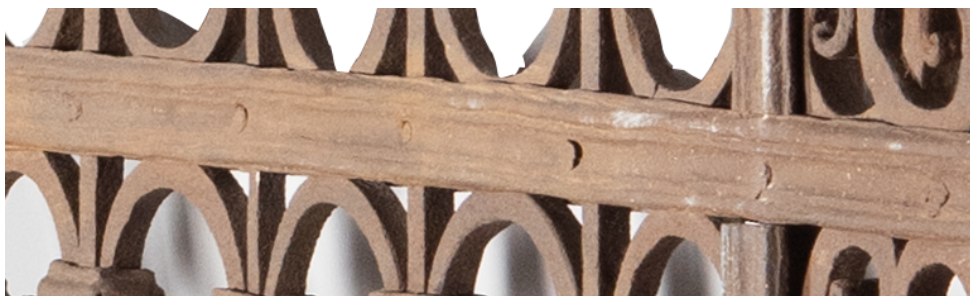
Abb. 72, Nieten im Bereich der Rahmenleiste, Stehflügel.
