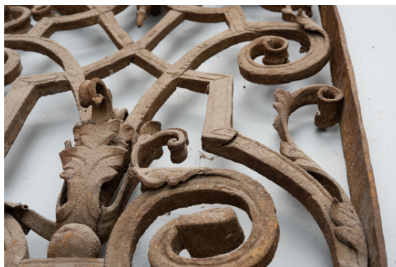
Abb. 121, Füllelement 2, verbogenes Gestänge.
