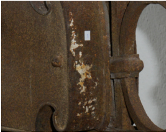
Abb. 72, Reste der weißen Substanz auf dem Schlosskasten. Gehflügel.
