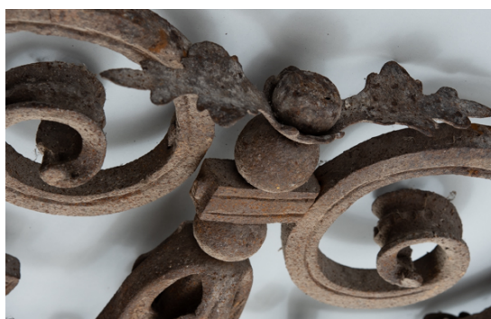
Abb. 125, Detail, Füllelement 1, oberer Bereich, gerissener Niet.
