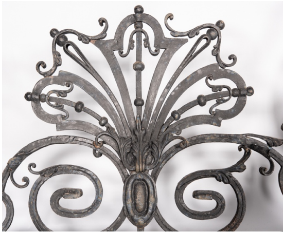
Abb. 140, Toraufsatz, diffundierende Eisenkorrosion, inhomogenes Erscheinungsbild.
