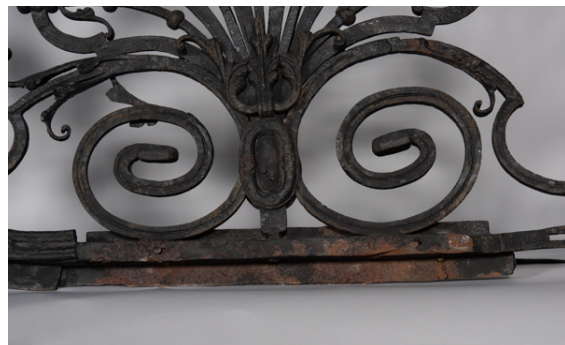
Abb. 135, Toraufsatz, unten rechts, fehlendes Abdeckblech.
