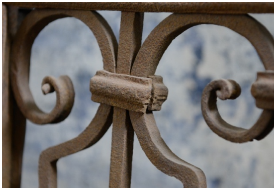
Abb. 114, Gehflügel, unterer Bereich, desolater und verbogener Bund.
