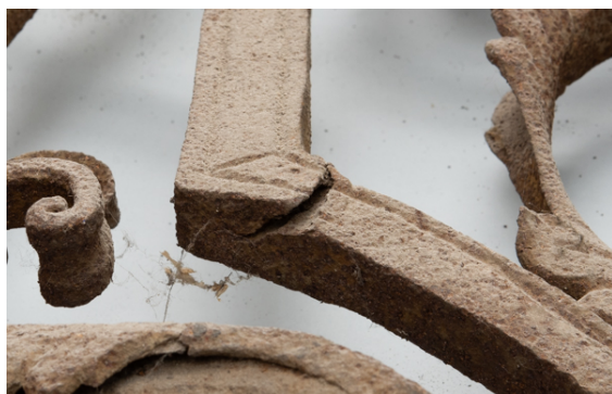
Abb. 122, Detail der Abb. 121, Füllelement 2, Riss im Bereich einer Feuerverschweißung.
