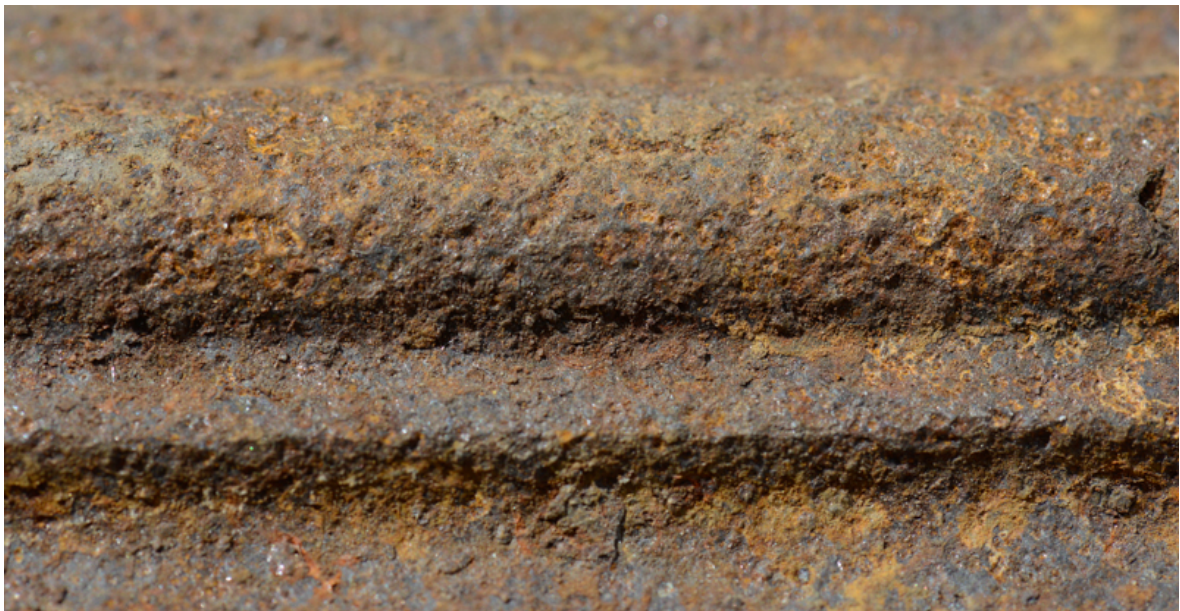
Abb. 101, Profilleiste des Tores, weit fortgeschrittene Muldenkorrosion am Objekt, deutlich erkennbare „Rostpusteln“.
