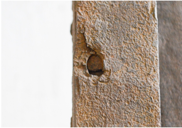
Abb. 112, unterer Rahmenfries, Stehflügel, ausgerissener Nietkopf.
