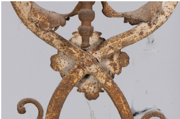
Abb. 130, Füllelement 2, oberer zentraler Bereich, fehlende Zierrosette.
