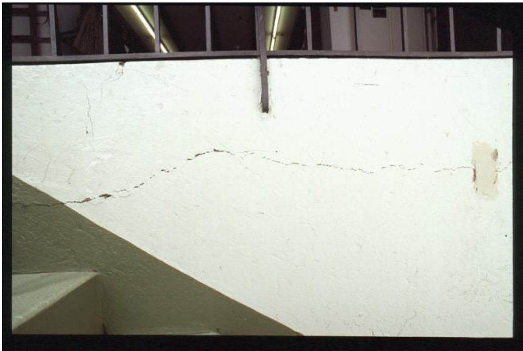
S.22 “Gebäuderisse - Gebäudesetzungen, die vermutlich auf eine schleichende Bewegung im Untergrund (Hangkante) zurückzuführen sind, verursachen im Boden und in den Wänden des Untergeschosses, insbesondere im Depotbereich, offene Risse. Ein Ausfugen der Gebäuderisse kann das eigentliche Problem jedoch nicht beheben.“
